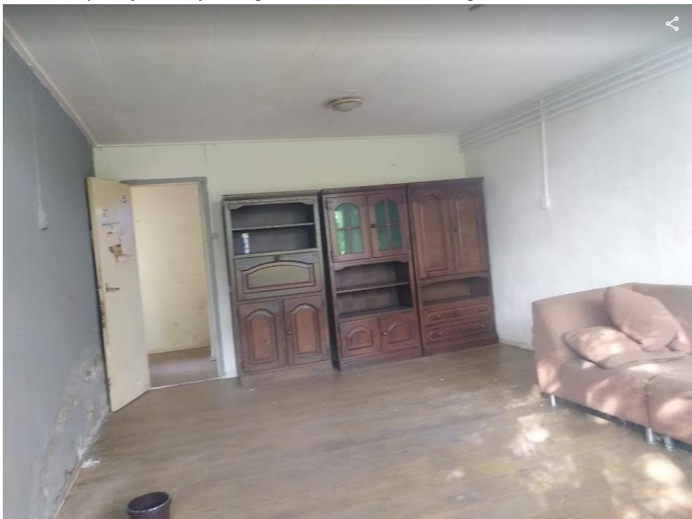
Schimmelvorming op de muren en vochtdoorslag muur links beneden. Nog steeds meubels aanwezig in de ruimte.
