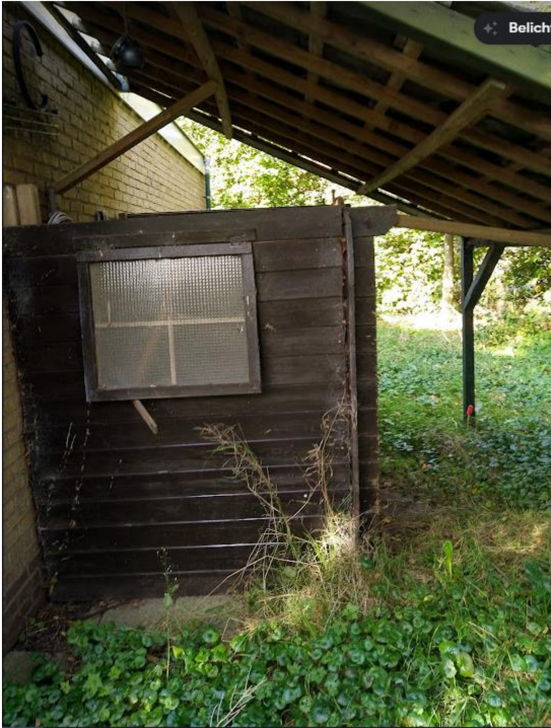
Schuurtje zonder dak en gammele overkapping welke door matige constructie bij elkaar gehouden wordt.
