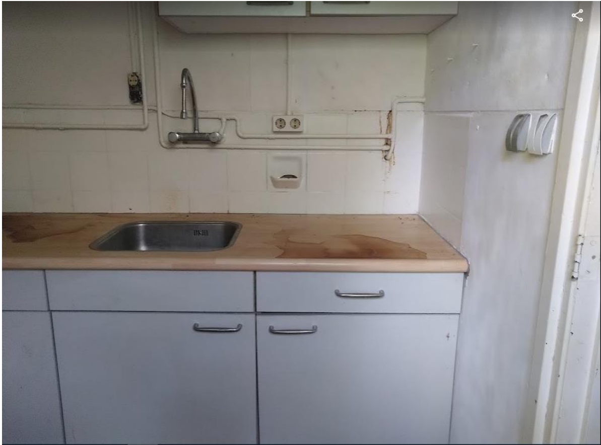
1 e keuken van het pand. Vocht op het aanrecht vanwege lekkage vanaf het dak. Hopelijk is de stroom afgesloten, zodat er geen kortsluiting kan ontstaan.
