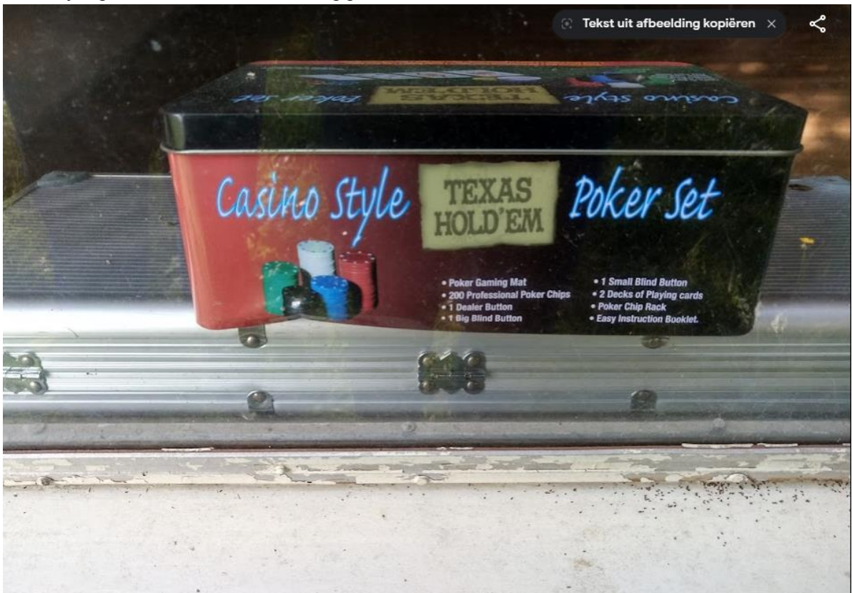
Raamsponningen zijn in slechte staat. Spelletjes aanwezig is voormalige gecreëerde woonunit.
