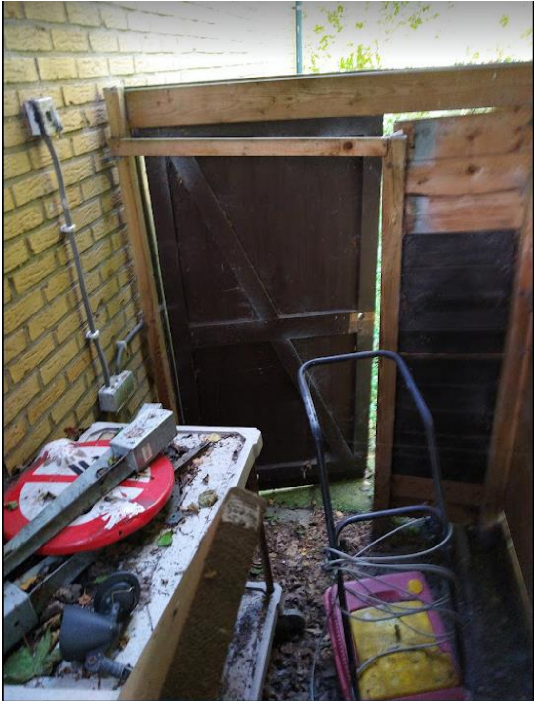
Inhoud van de schuur gefotografeerd via het dak, welke niet aanwezig is. Stroomvoorziening aan de muur is niet veilig, en de overkapping hierboven staat op instorten.
